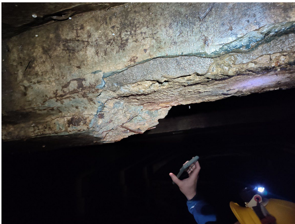
Foto 3 . Betoane distruse, elemente metalice expuse umiditatii
