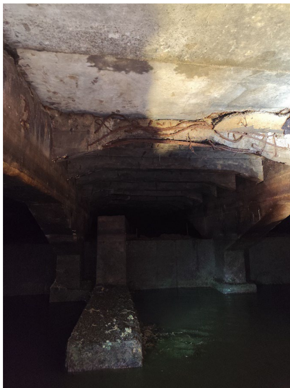
Foto 9 – Armături complet expuse, deformat, antretoaza iesita din lucru
